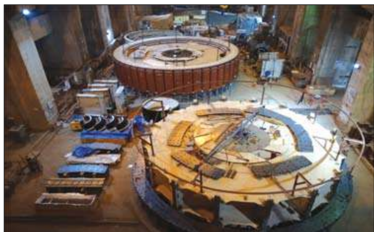
Power Hose - Subansiri Lower
